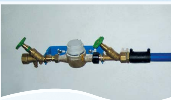
Bild 4: Wasserzähler nahe Kelleraußenwand
