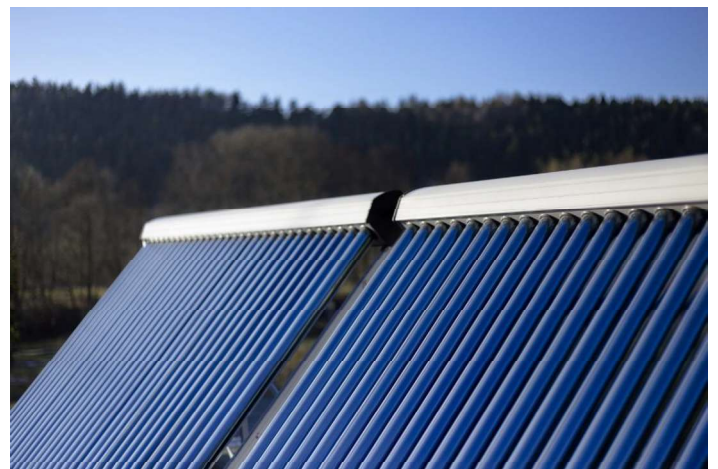
Solarthermie – hier Vakuumröhrenkollektoren
